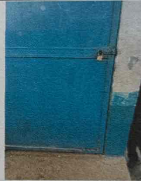
Foto 4: Se observa el deterioro de las puertas de metal.
