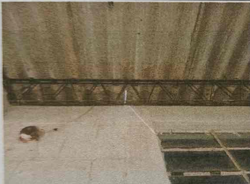
Foto 3: Se observa que la estructura de soporte están oxidadas y en mal estado.
