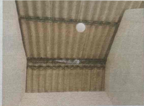
Foto 2: Se observa el mal estado, en la que se encuentra el techo de la dirección del centro educativo.
