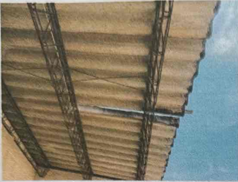
Foto 1: Se observa el deterioro de la duralita. Se cambiará por las malas condiciones en las que se encuentra ya que provoca filtración de agua durante el invierno.
